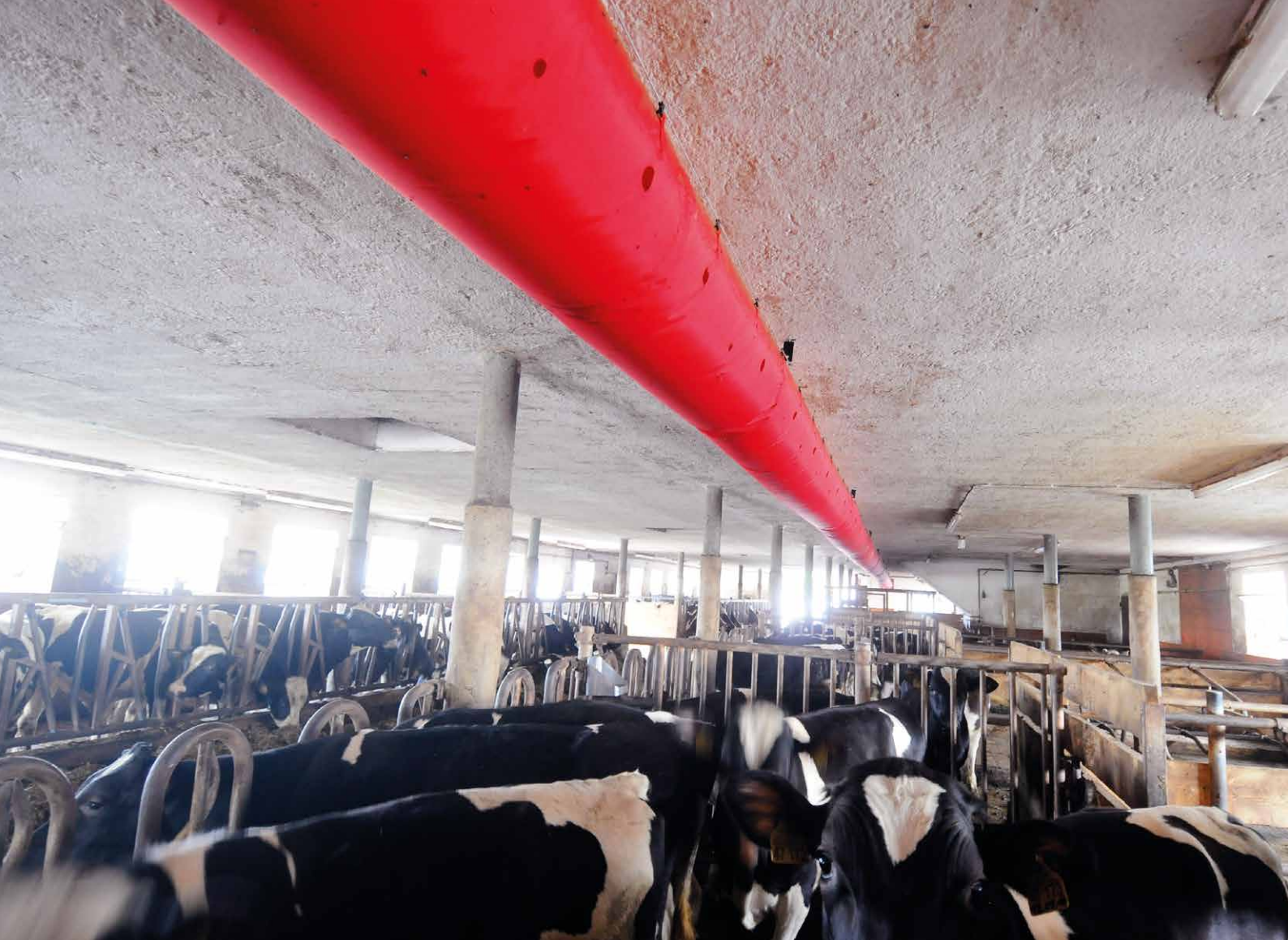
Schlauchbelüftung CAT 3000 im Kälber-/Jungrinderstall (Altbau) von Peter Thanner, Ostermünchen Zwei Schläuche, Schlauchlänge: je ca. 21,5 m, Ø 45 cm mit zwei gegenüber liegenden Ventilatoren, Gesamtlänge: 43 m
