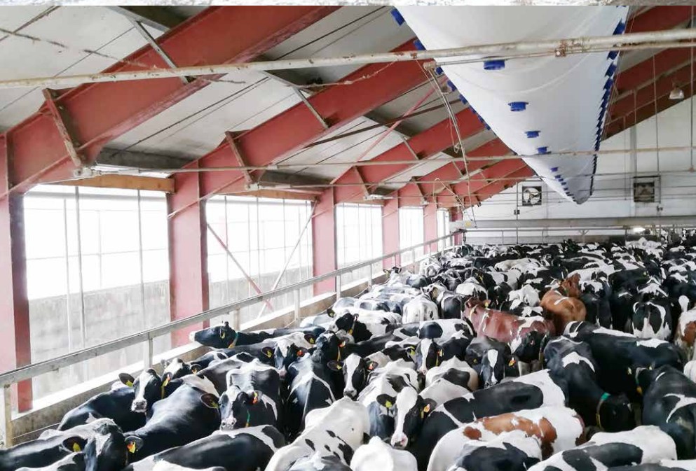
Schlauchbelüftung CAT 3000 GEGEN HITZESTRESS installiert im Wartebereich der FirstFarms s.r.o – einem der größten land- wirtschaftlichen Betriebe der Slowakei
